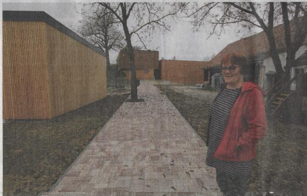
Marija Glavinič na gradbišču njihovih apartmajskih hišk, kajž, v Vinskem vrhu. Foto Jože Pojbič
